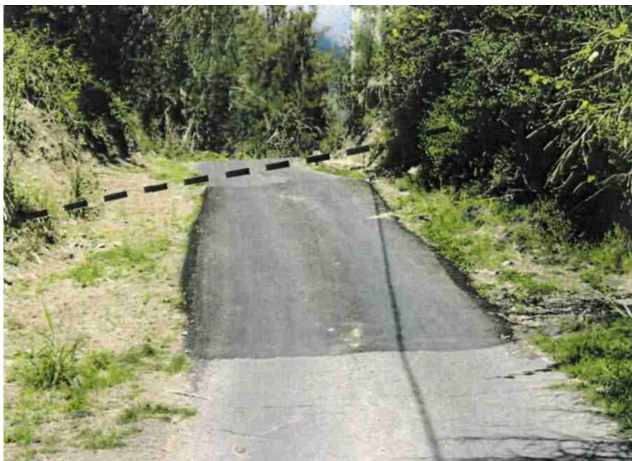
Figure 4: Déformation du chemin en béton reliant la RD48 et le Fond de Rond-Point, dans le glissement de Mare à Poule d'Eau. Le rejet vertical est métrique. Photo correspondant à la Figure 20 de Garnier et Lucas, 2008.
